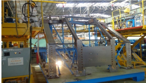
Construction de la coque de la cabine avant à l'usine Nippon Sharyo
