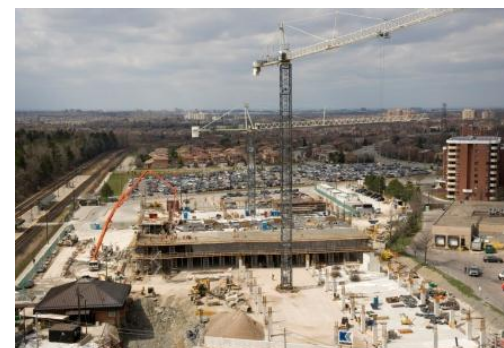
Construction du parc de stationnement en élévation à la gare GO Erindale
